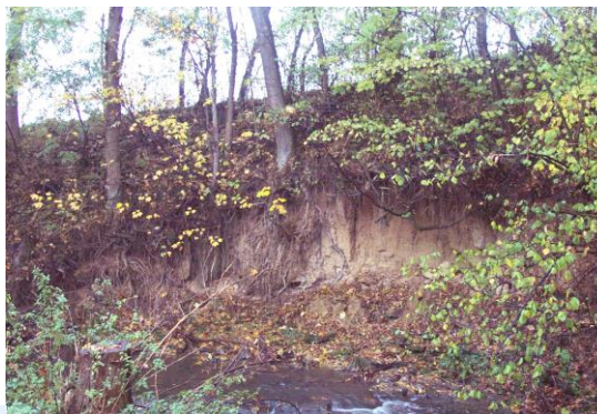
Abbildung 3: Unterspülung am Prallhang; Unterhaltungsmaßnahme im Rahmen der Verkehrssicherung erforderlich (Foto: Angelika Lugibihl)
